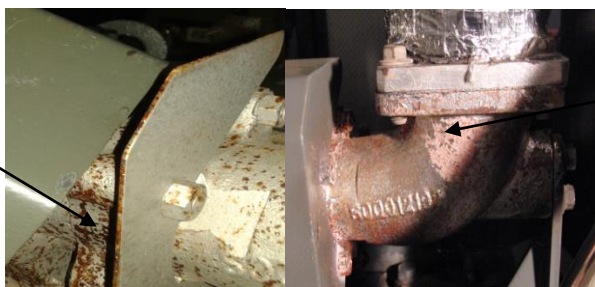
Rys. 20. Korozja elementów silnika zespołu
