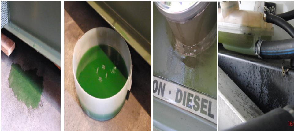
Rys. 12. Liczne wycieki płynów eksploatacyjnych (na zewnątrz i wewnątrz zespołu)
