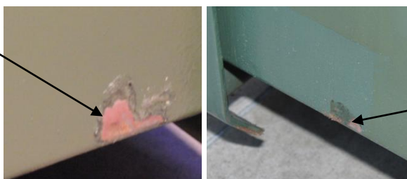
Rys. 21. Korozja na zewnątrz zespołu i malowanie na wiele różnych kolorów
