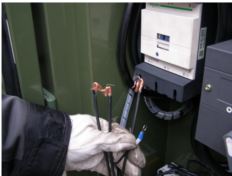
Rys. 9. Brak zakończeń przewodów oraz oznaczeń przewodów toru głównego (dodatkowo bardzo zła kultura techniczna wykonania)
